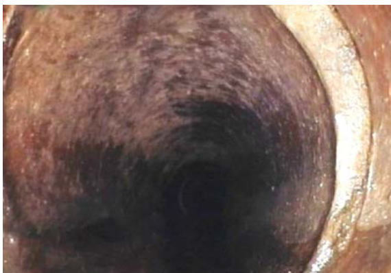
c) Verschobene Rohrverbindung (Schadensklasse B)
