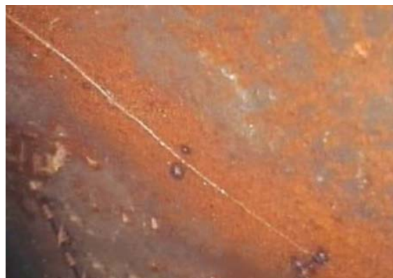
d) Haarriss (Schadensklasse C)
