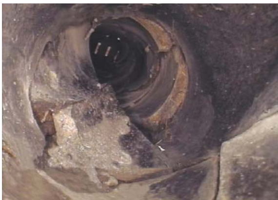
a) Rohrbruch (Schadensklasse A)
