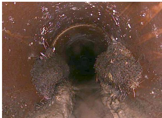
b) Wurzeleinwuchs (Schadensklasse A)
