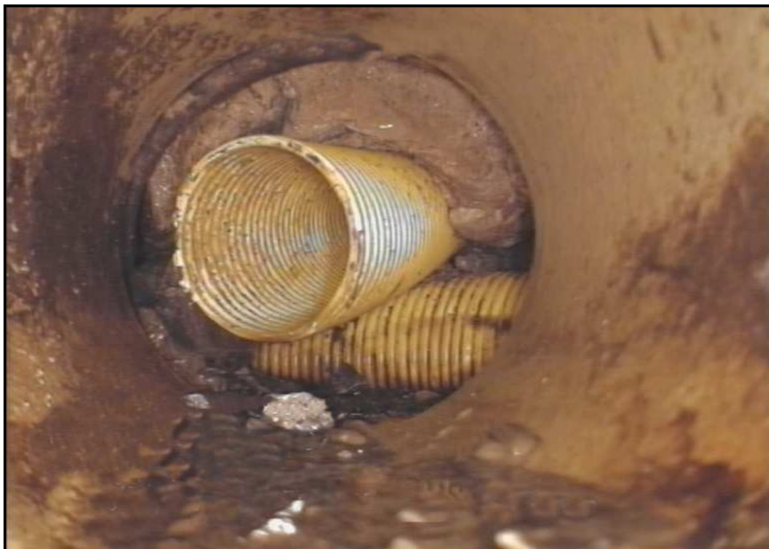
Abb. 1: Dränagenanschluss (Quelle: Gemeinde Möhnesee)
