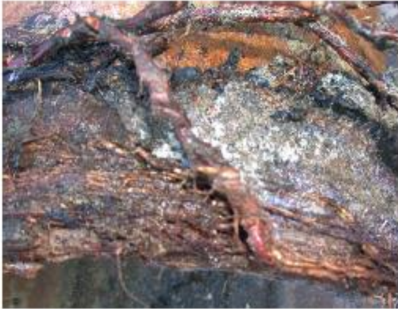
Abb. 124: Wurzeln sind außerhalb der Rohrverbindung um die Leitung gewachsen. Eine verholzte Wurzel ist durch die Vergussmasse in die Rohrverbindung gewachsen.
