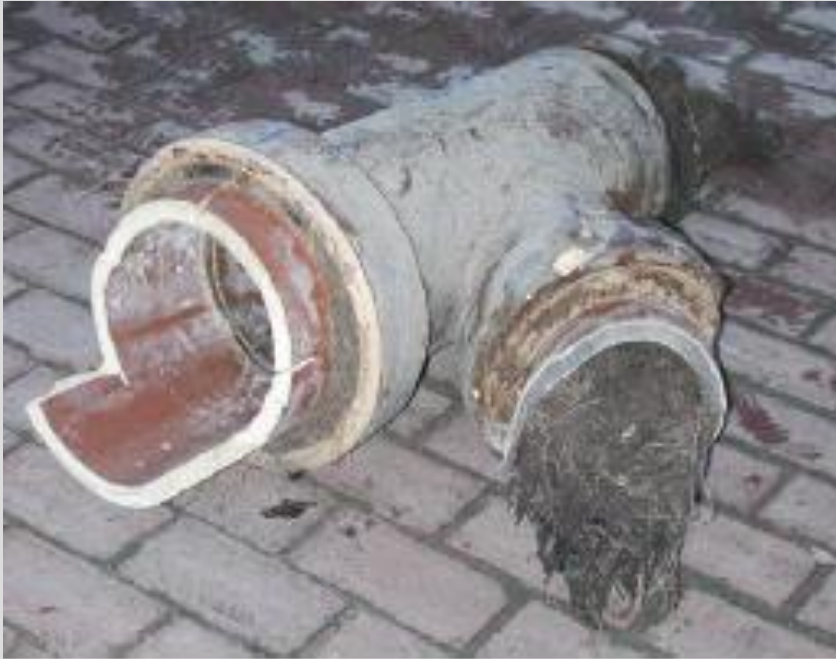
Abb. 106: Wurzeln haben einen nicht in Betrieb befindlichen Zulauf im Abzweig eines Schmutz-wasserkanals verstopft. Die Wurzeln haben gleichmäßig den gesamten Querschnitt ausgefüllt.
