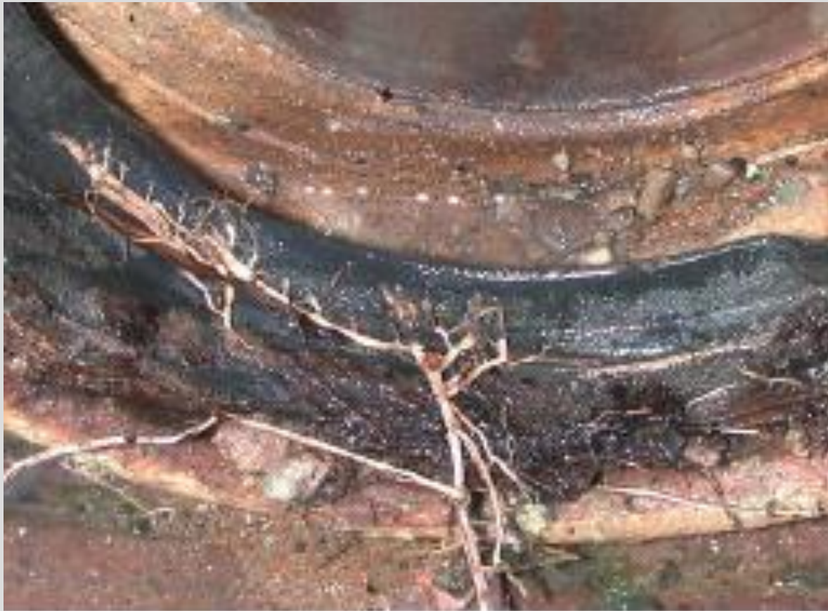
Abb. 61: Die Wurzeln sind nicht über die Lichtlippe der Steckverbindung in den Leitungsquerschnitt gewachsen. Sie sind entlang des Elastomer-Dichtelment quer um die Leitung gewachsen.
