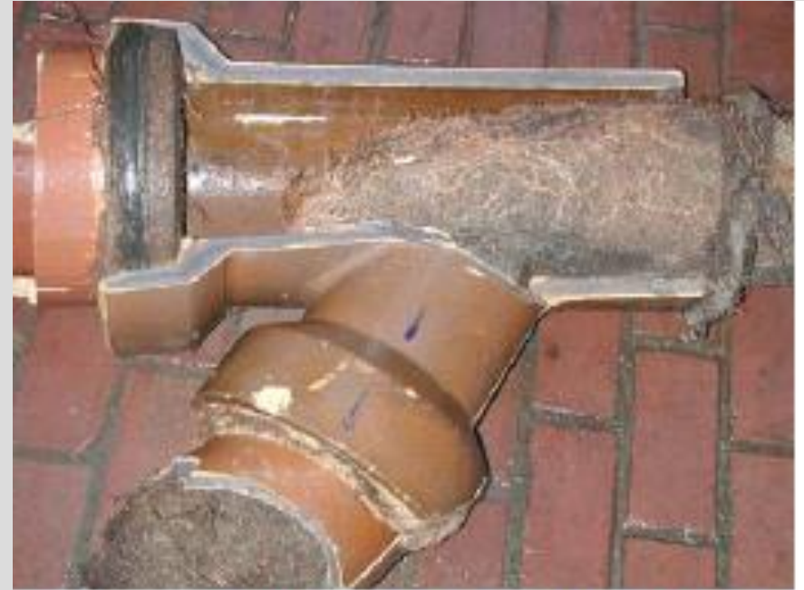
Abb. 107: Die Wurzeln sind durch den seitlichen Zulauf des Hauptkanals eingewachsen. Durch starke Verzweigung der Wurzeln hat sich ein Polster gebildet, das den Querschnitt der Hauptleitung nahezu völlig einnimmt.
