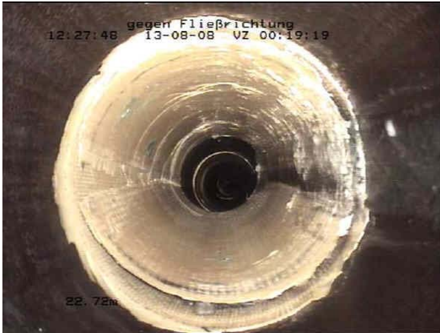
Bild 9: Abflusshindernis durch nicht fachgerecht eingebauten Kurzliner
