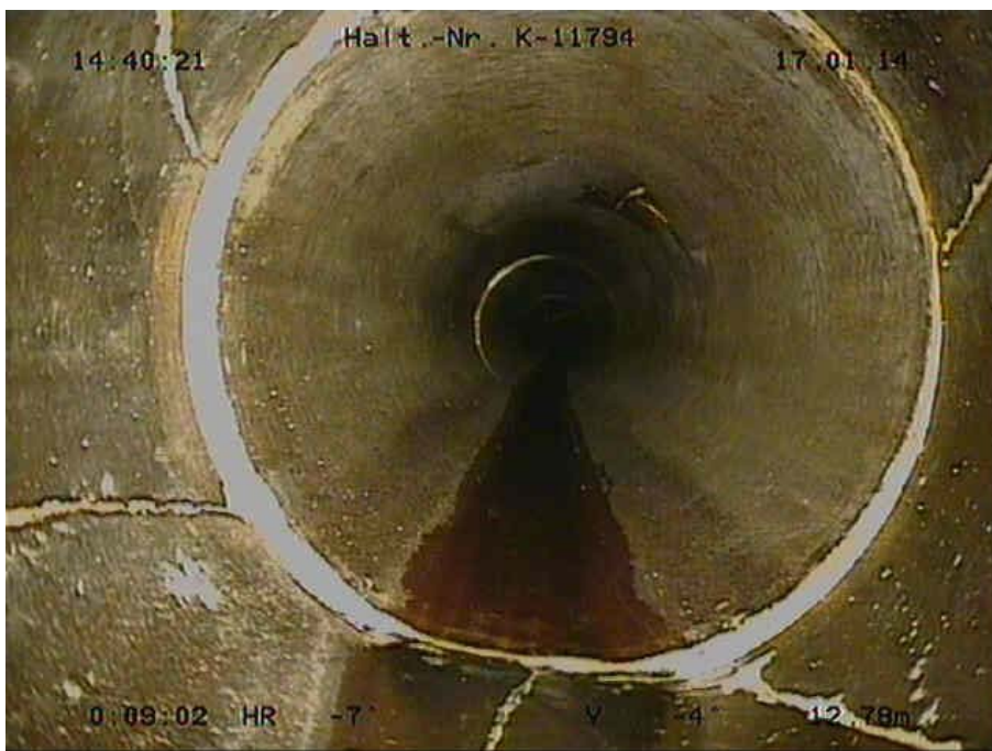
Bild 7: Scherbenbildung nach Sanierung mittels Injektion
