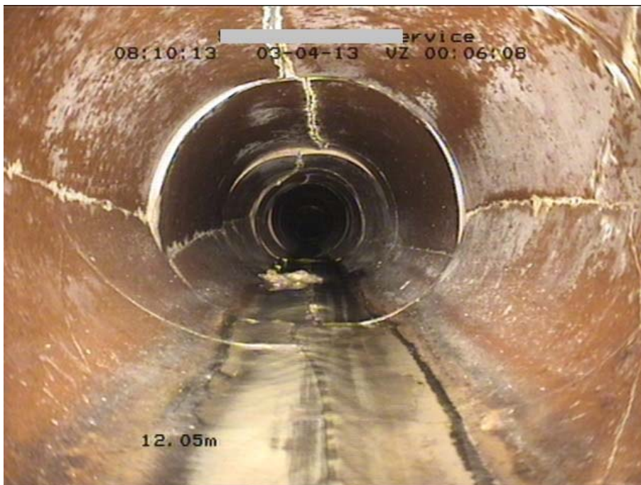
Bild 4: Einsturzgefahr bei Vorfräsarbeiten
