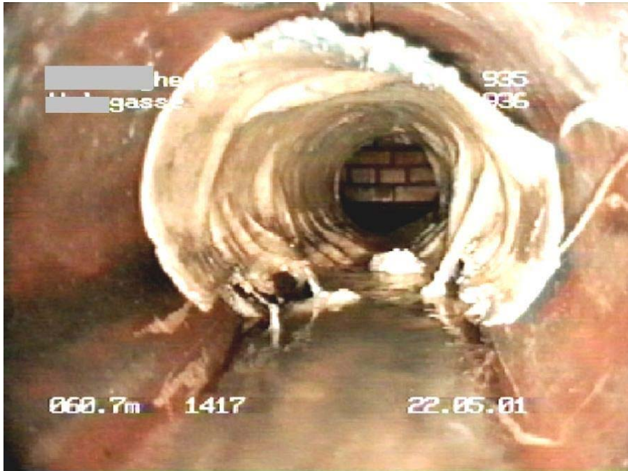
Bild 1: Nicht fachgerecht eingebauter Kurzliner
